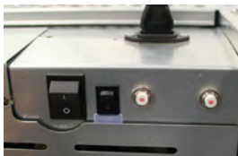
Abbildung 4: Stromschalter AC EIN/AUS (links), Schalter der Reservebatterie des Überwachungssystems/der Zugangskontrolle EIN/AUS (Mitte), Schutzschalter (nur Systeme mit 230 V) (rechts).
