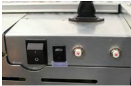
Figure 4 : le commutateur CA ON/OFF (à gauche), le commutateur ON/OFF de la batterie de secours du système de surveillance/contrôle des accès (au centre), les disjoncteurs (systèmes 230 V uniquement) (à droite)
