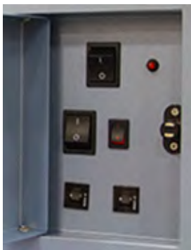
Figur 4: Strömbrytaren PÅ/AV (högst upp på mitten), PÅ/AV-brytare för reservbatteriets i.C 3 övervakningssystem/åtkomstkontroll (höger sidan på mitten), automatsäkring (längst ned).
