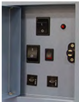
Figura 4: interruttore ON/OFF di corrente CA (in alto al centro), interruttore ON/OFF della batteria di backup i.C 3 per monitoraggio/Access Control (al centro-destra), interruttori automatici (in basso).
