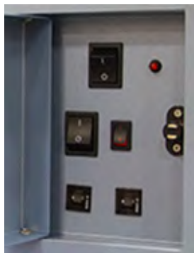
Afbeelding 4: AC AAN/UIT-schakelaar (boven in het midden), AAN/UIT-schakelaar voor de reservebatterij (midden rechts) van de i.C 3 monitoringsysteem/toegangscontrole, zekeringen (onder).
