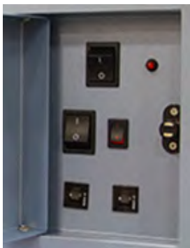
Figur 4: vekselstrøm ON/OFF afbryder (midt øverst), i.C 3 overvågnings-/adgangskontrollens backup-batteris ON/OFF afbryder (midten til højre), hovedafbrydere (nederst).
