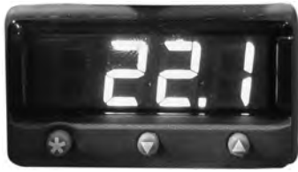
Monitor della temperatura/display della centralina e pulsanti.
