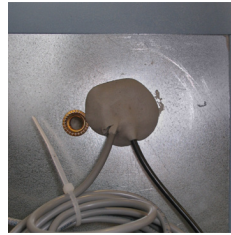
Abertura de acesso traseira - frigorífico sob a bancada
